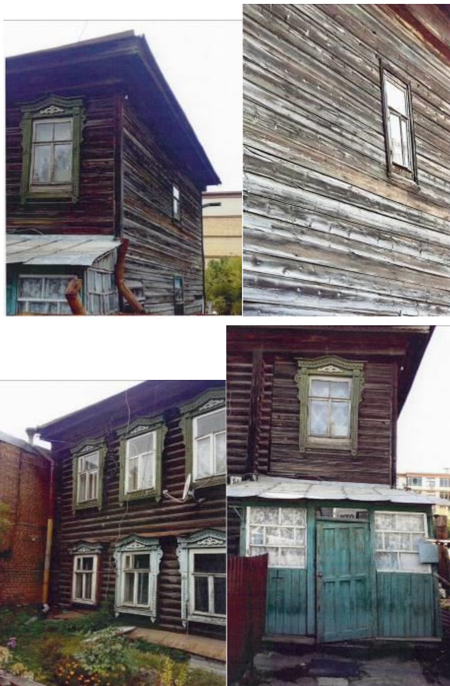
Рис.2. Фотографии фрагментов с характерными дефектами
