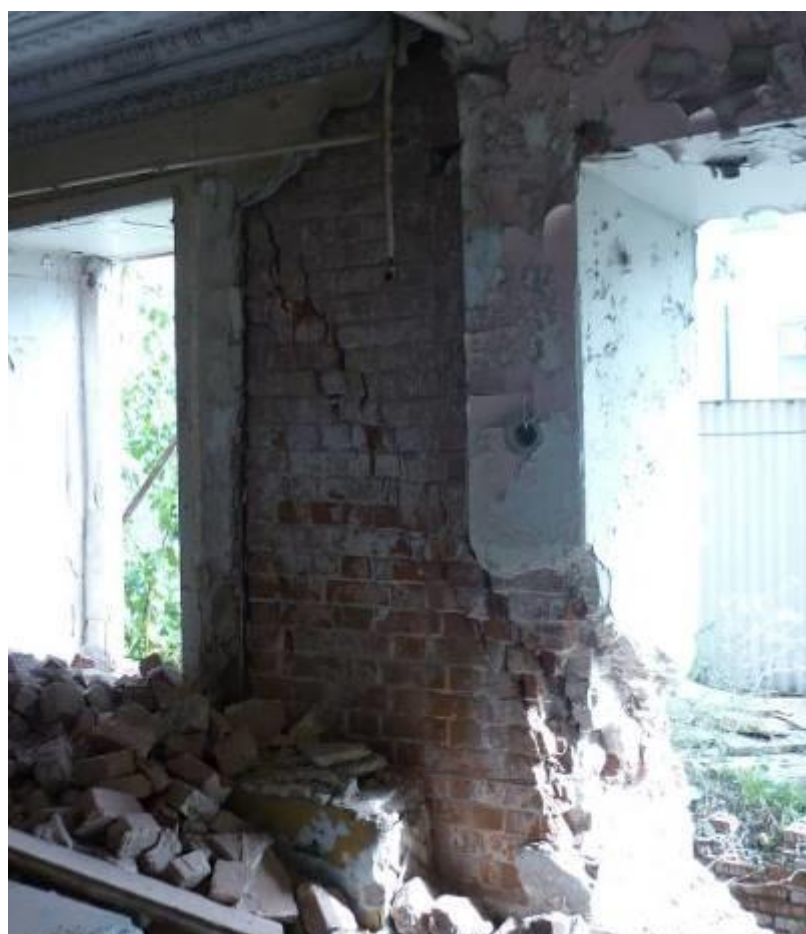
Рис. 5. Наклонная трещина в каменном простенке (20 мм)
