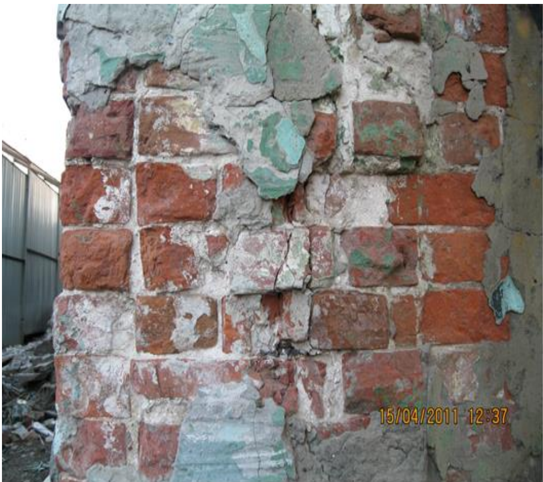
Рис. 1. Вертикальная трещина в каменном простенке (4 мм)
