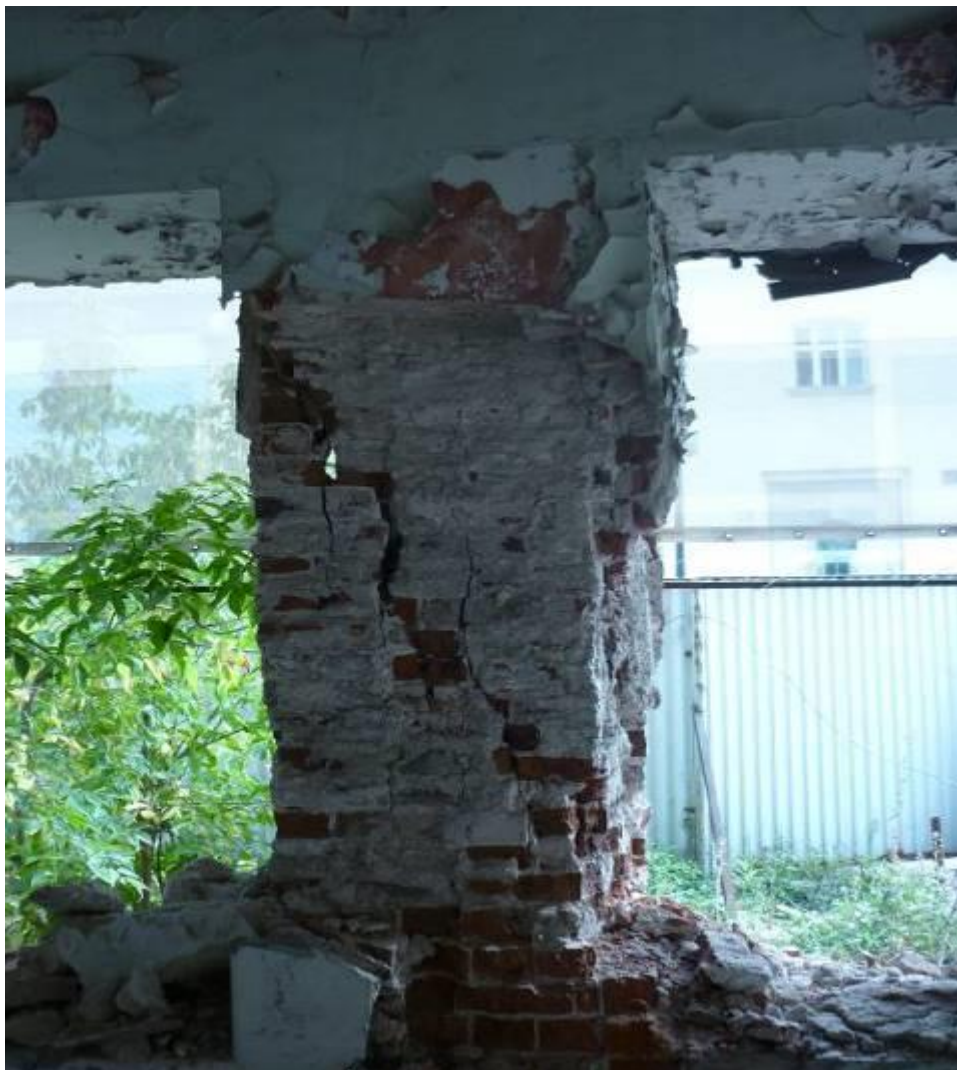
Рис. 2. Наклонная трещина в каменном простенке (25 мм)
