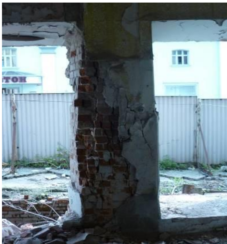
Рис. 4. Вертикальные трещины в каменном простенке (15мм)
