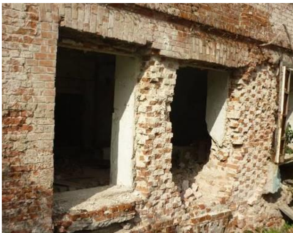
Рис. 3. Разрушение кирпича, раствора наружной версты кладки
