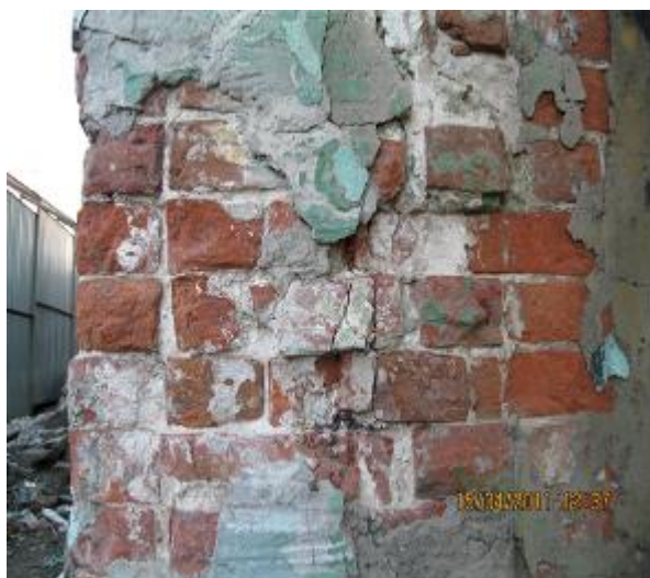
Рис. 1. Вертикальная трещина (4 мм)
