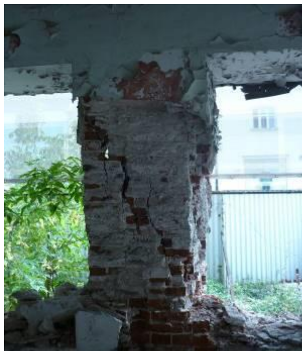
Рис. 2. Наклонная трещина (25 мм)
