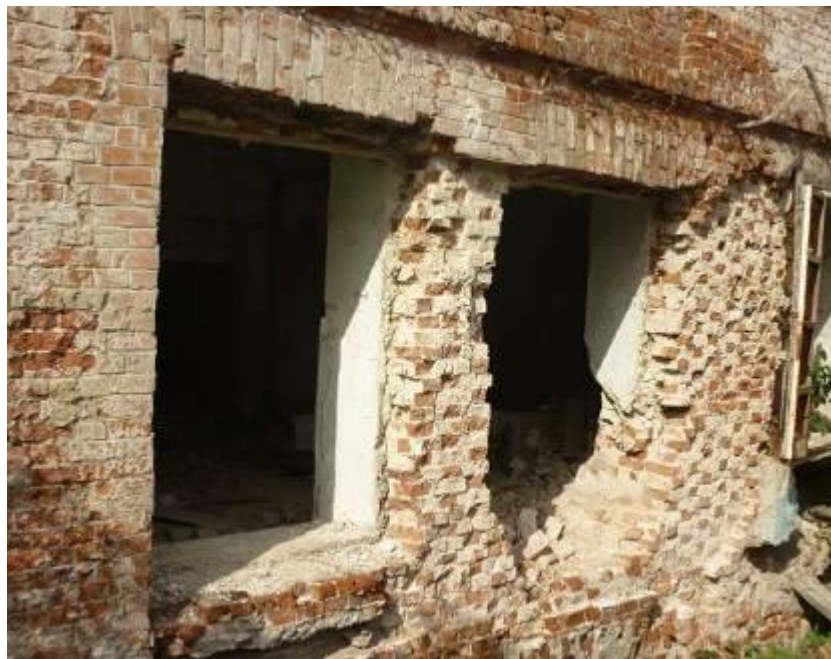
Рис. 3. Разрушение кирпича, раствора
