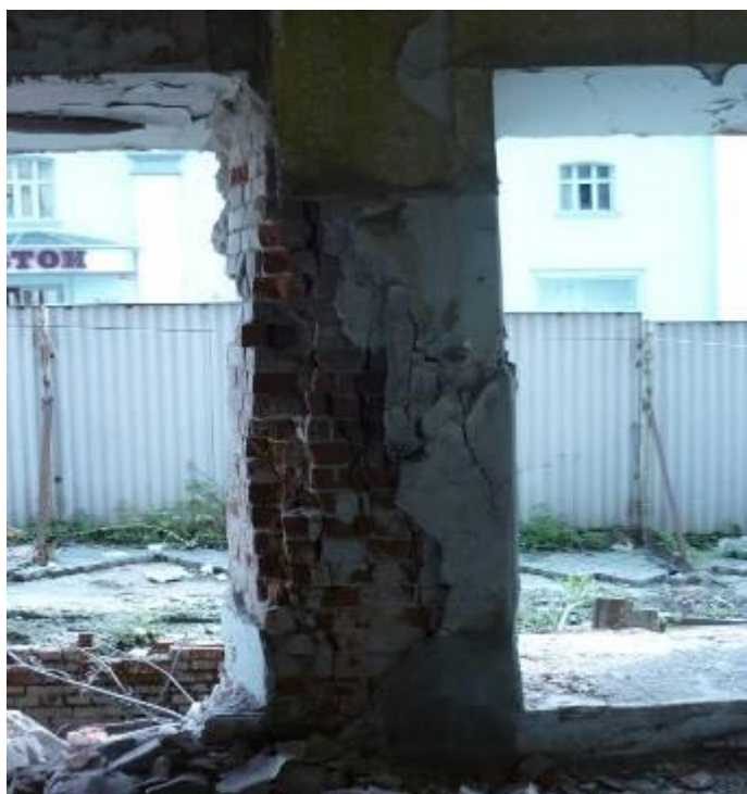
Рис. 4. Вертикальные трещины (15мм)
