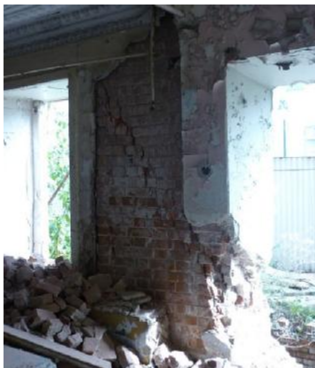
Рис. 5. Наклонная трещина (20 мм)
