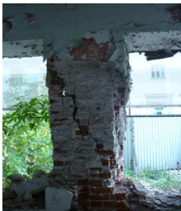
Рис. 2. Наклонная трещина (25 мм)
