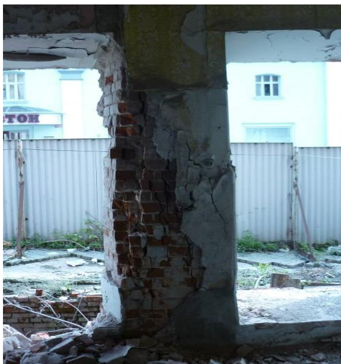
Рис. 4. Вертикальные трещины (15мм)
