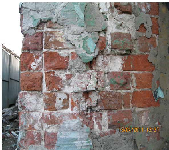
Рис. 1. Вертикальная трещина (4 мм)
