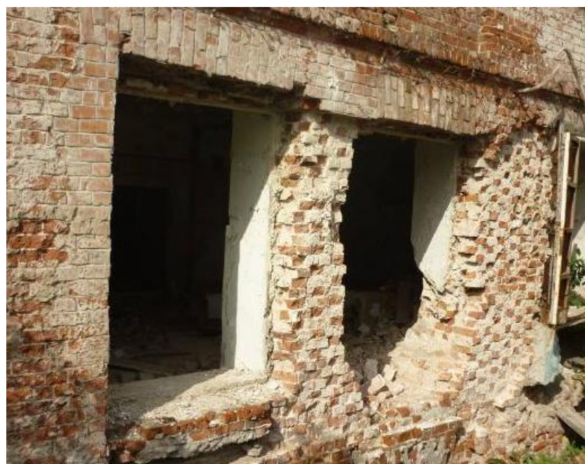
Рис. 3. Разрушение кирпича, раствора
