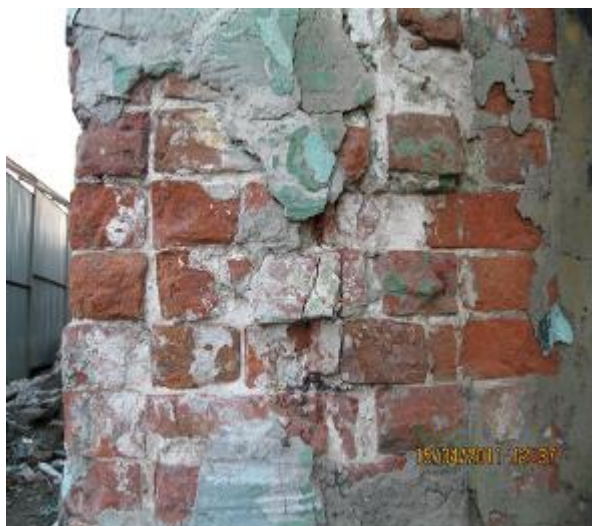
Рис. 1. Вертикальная трещина (4 мм)
