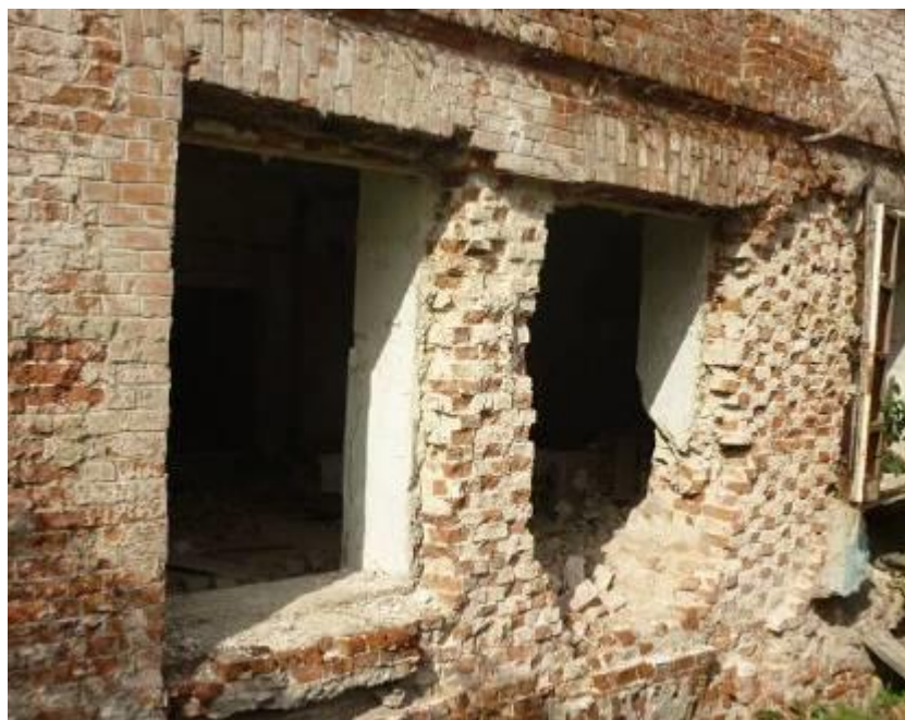
Рис. 3. Разрушение кирпича, раствора
