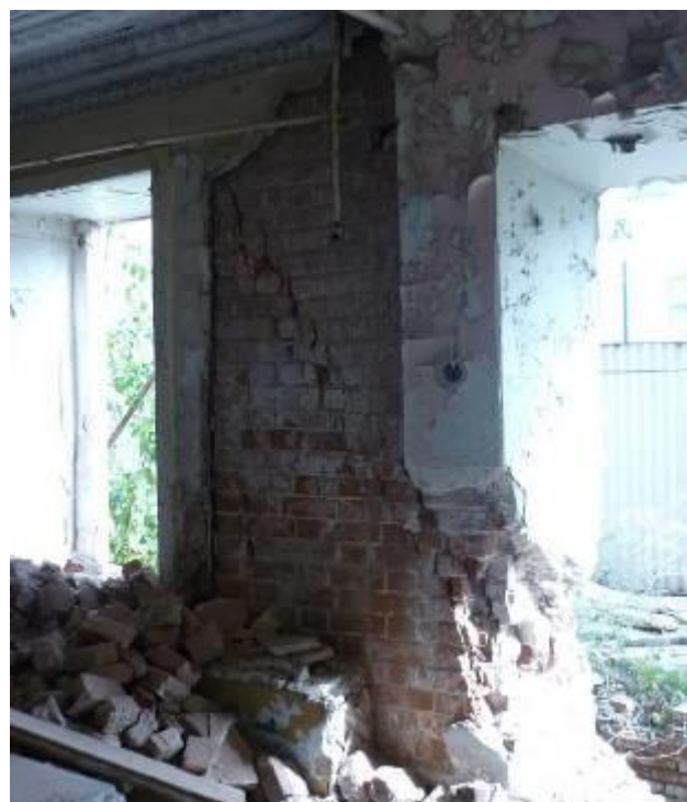
Рис. 5. Наклонная трещина (20 мм)
