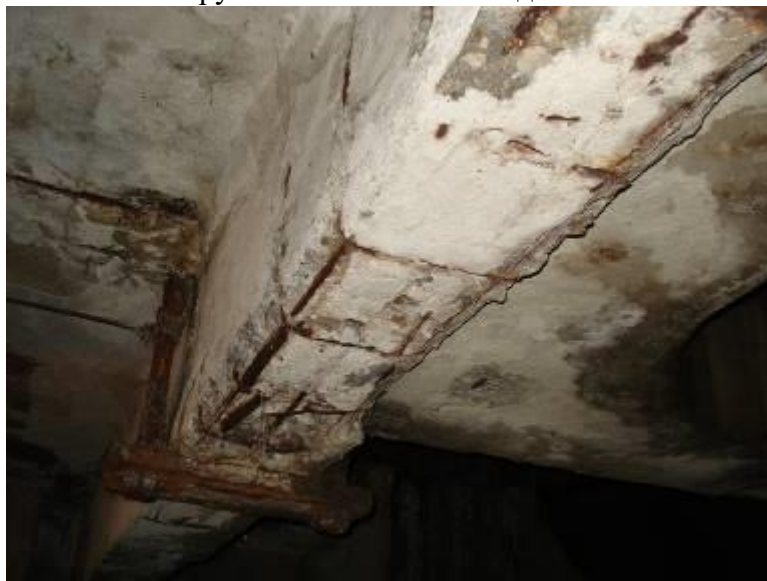
Рис.2. Фотографии фрагментов с характерными дефектами (пример)
