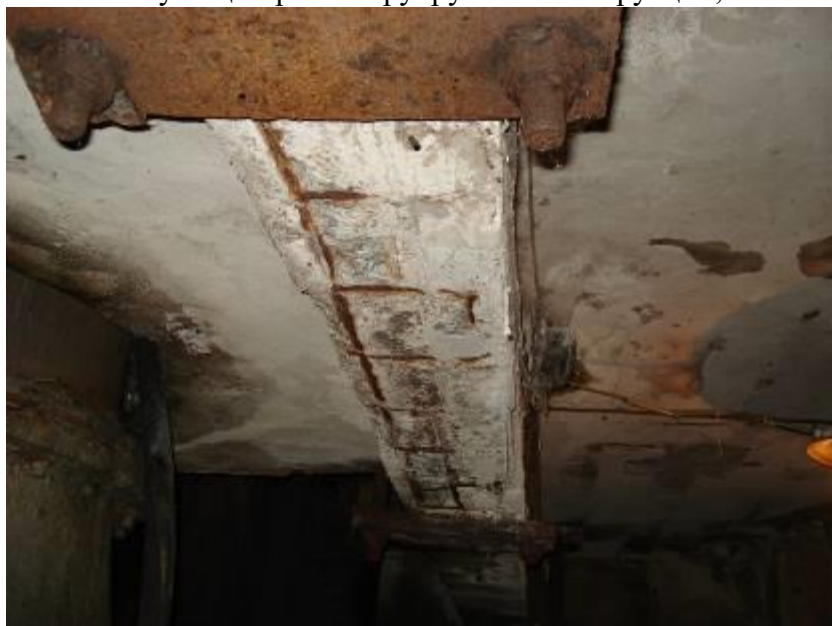
Рис.1. Фотография общего поврежденной конструкции
