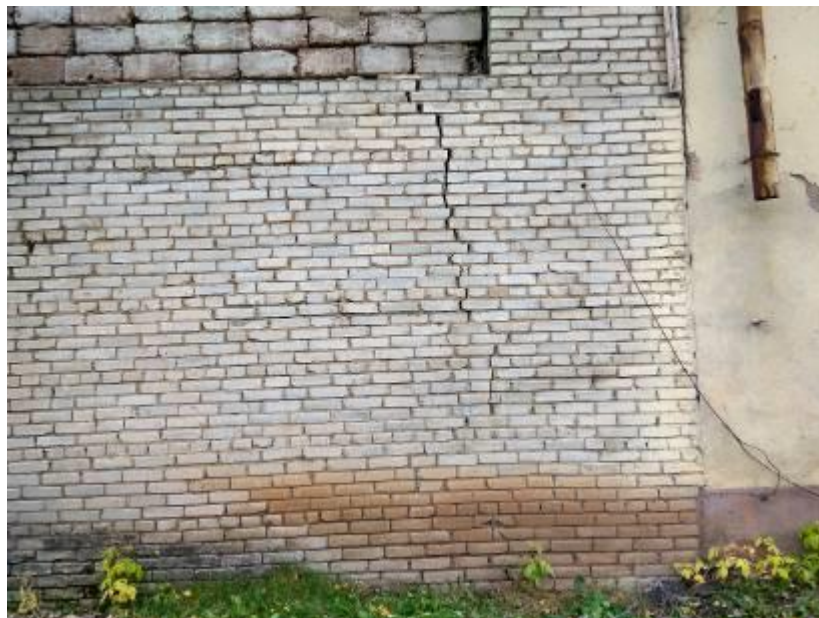
Рис.2. Фотографии фрагментов с характерными дефектами (пример)
