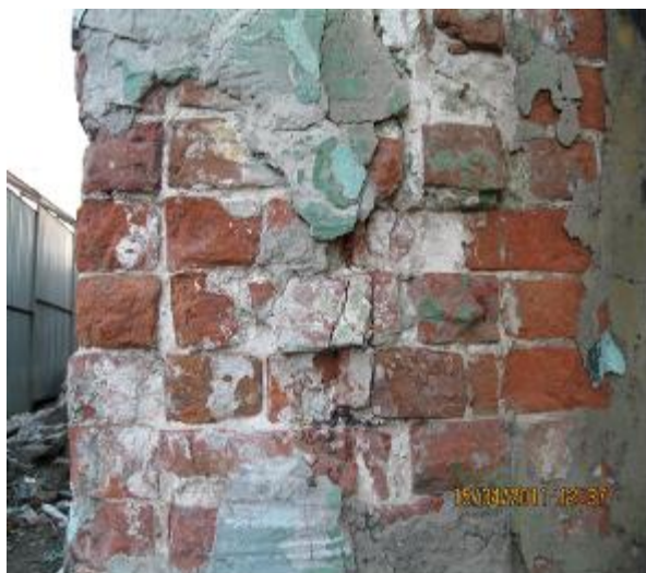
Рис. 1. Вертикальная трещина (4 мм)
