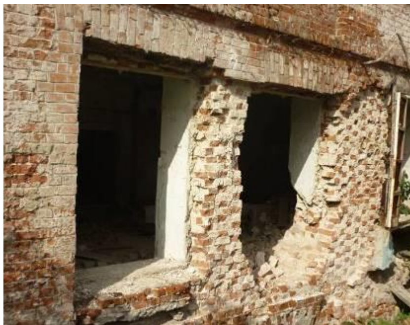
Рис. 3. Разрушение кирпича, раствора
