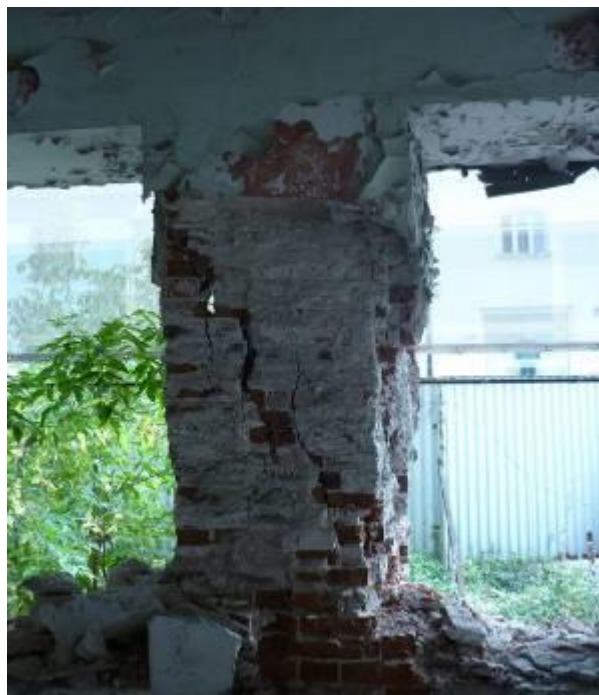
Рис. 2. Наклонная трещина (25 мм)
