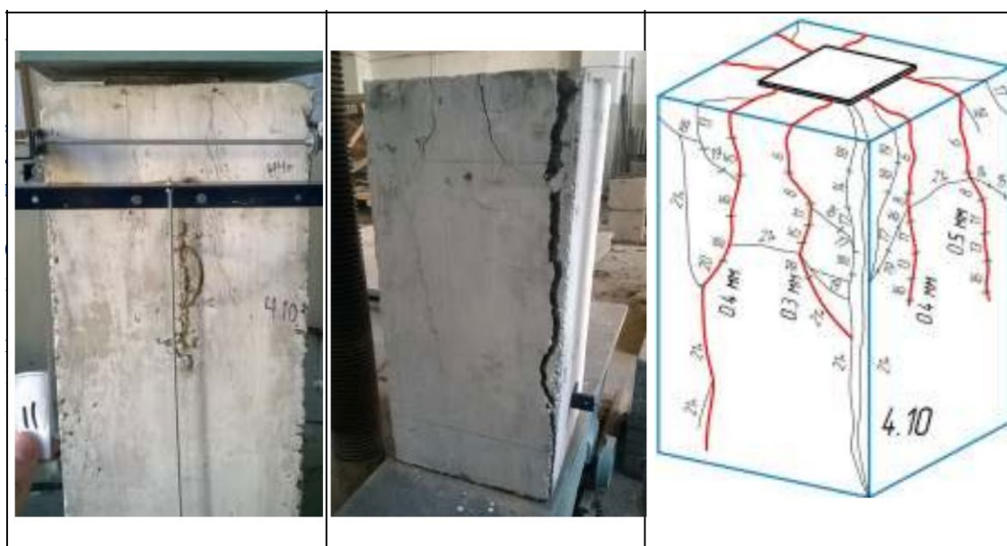
Рис. 5.2. Сравнение характера трещинообразования оголовка колонны
