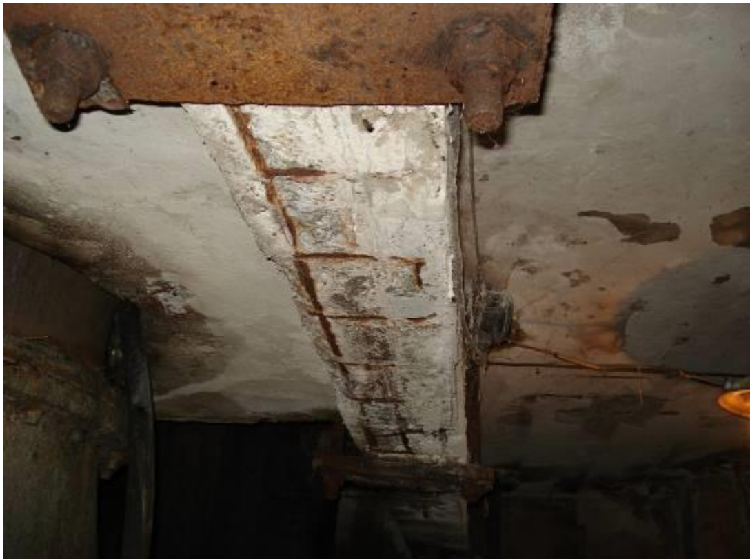
Рис.3. Сколы бетона, коррозия арматуры, разрушение защитного слоя балки.
