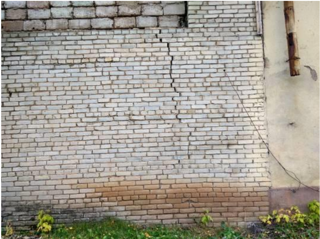
Рис.2. Трещина (ширина раскрытия 12 мм), замачивание цокольной части стены.
