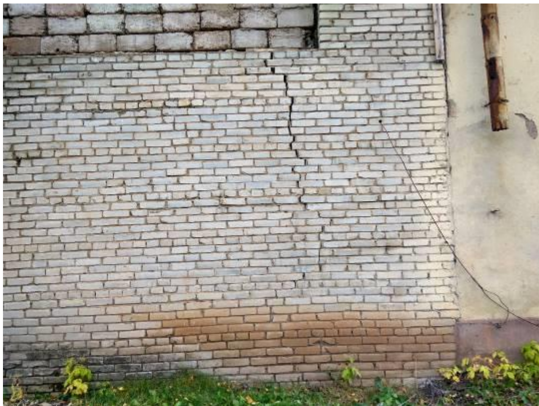
Рис. ____. Трещина (ширина раскрытия 12 мм), замачивание цокольной части стены.
