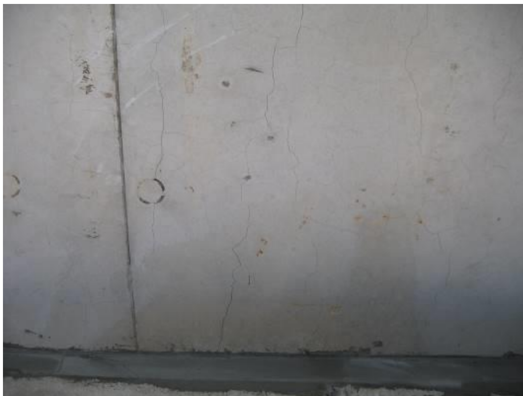
Рис. ____ Усадочные трещины в плите 4 этажа (оси 1-2/А-А/1)
